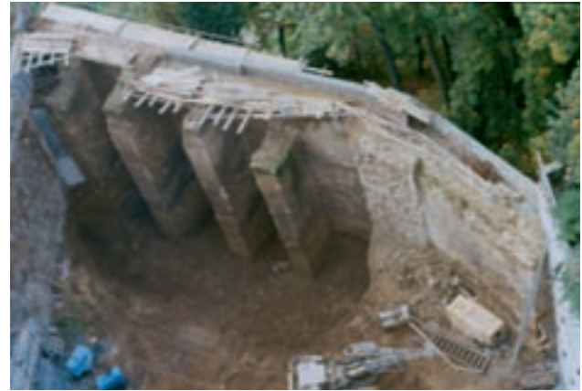
Baugrube und Teil der Bastion Louis, nachdem einer der Stützpfiler abgetragen worden ist. (A. B. und Geotop)
